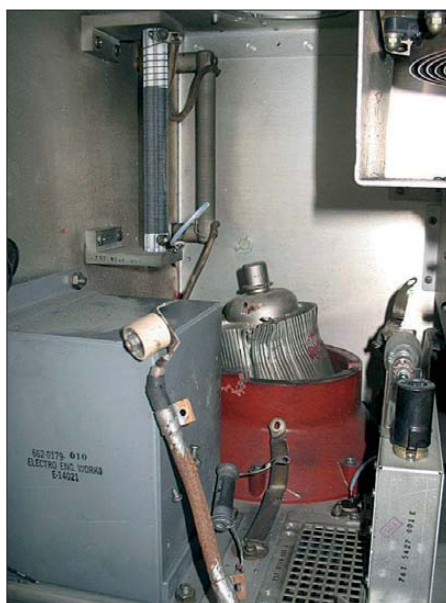
Bild 2: Transportschaden am KW-Sender Collins 208-U3
