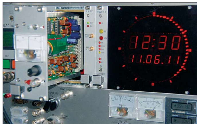
Bild 1: Die Baugruppe ist in eine Kassette (10 TE) eingebaut und direkt neben einer Cäsium-Uhr eingeschoben. Für diese Aufnahme wurde ihre rechte Abschirmung entfernt und das Modul nur teilweise eingesteckt.
